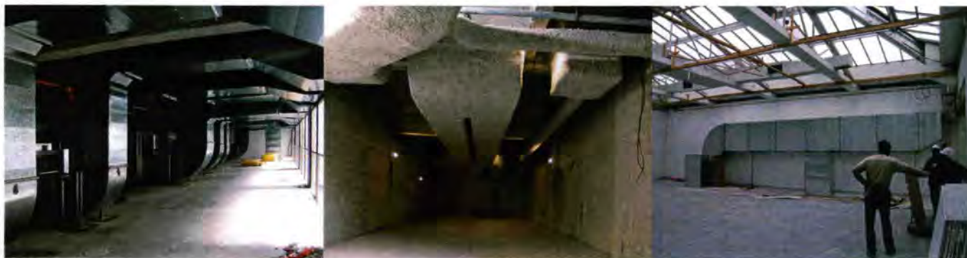
Réseaux de passage de gaines.
