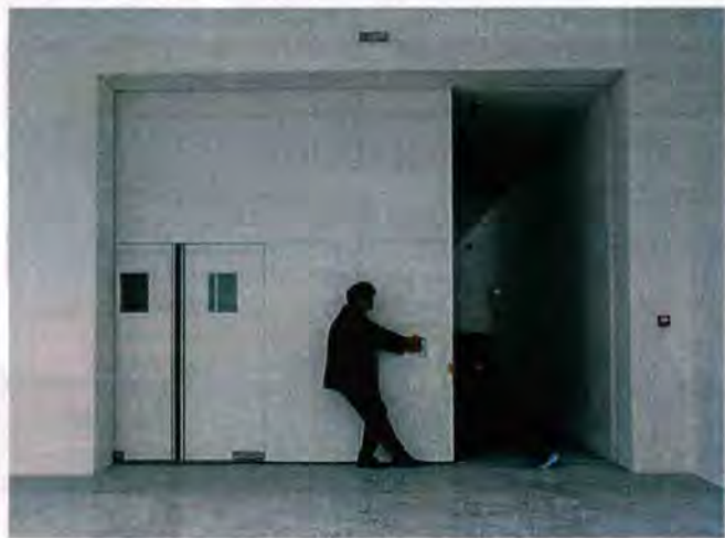
La porte pare flammes de degré 1h 30 est dissimulée derrière une double cloison. Elle intègre un portillon en va-et-vient pour évacuer le public en cas d'incendie.
